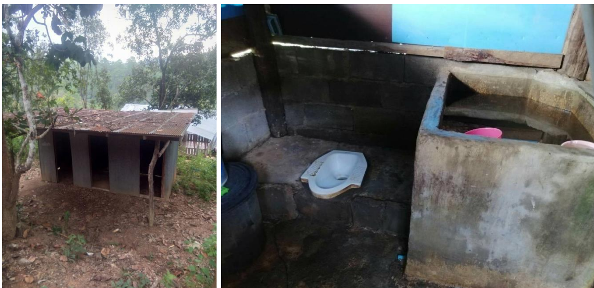
De huidige staat van de toiletten op het project
